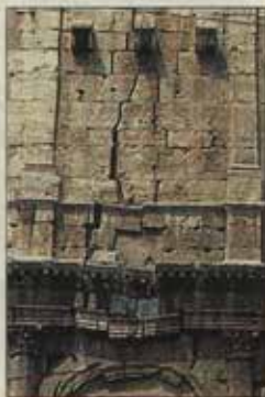
Il Colosseo e, sopra, la crepa che si è aperta nel monumento. Nell'altra pagina, il nuovo Piccolo Teatro di Strehler, a Milano: costato cento miliardi e mai completato
